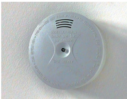
Abb. 11: Herkömmlicher Rauchmelder an der Decke befestigt
