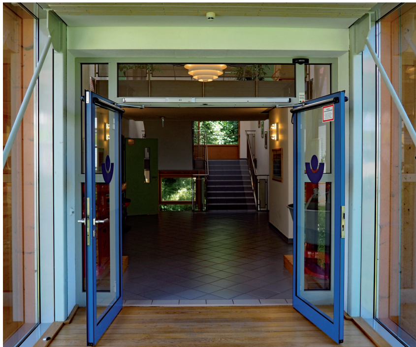
Abb. 12: Zweiflügelige Feuerschutztür mit Rauchsensor und automatischer Türschließung.
