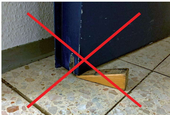
Abb. 13: Verbotenes Verkeilen einer Brandschutztür
