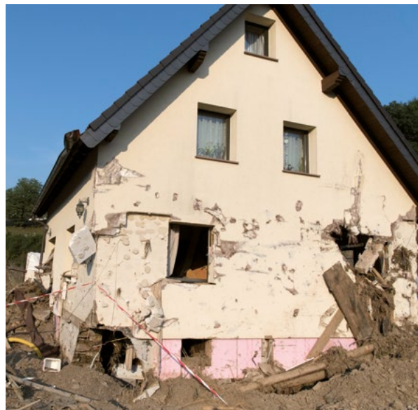
Die Sturzfluten von Tief Bernd haben im Juli 2021 enorme Schäden an Wohngebäuden, Hausrat und Betrieben verursacht. (Foto: © GordonGrand / stock.adobe.com)
